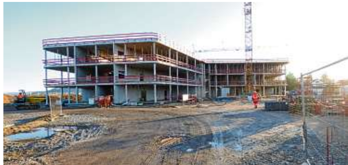
Knapp 120 interessierte Bürgerinnen und Bürger kamen am Donnerstag, 6. Februar, zum Dorfgespräch an der Baustelle der neuen Eichendorff-Realschule, um den Fortschritt der Bauarbeiten zu betrachten. Näheres auf Seite 3.
