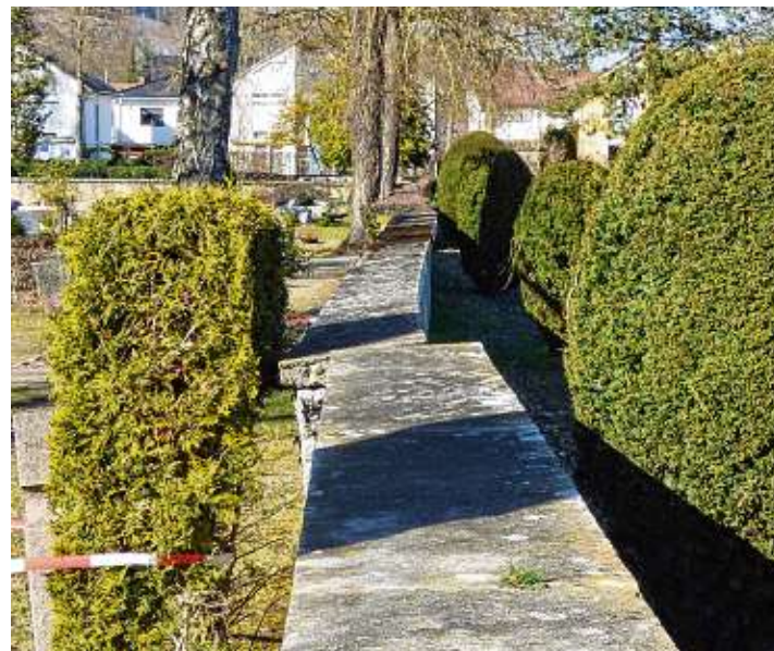
Das Mauerstück an der Ostseite neigt sich deutlich aus der Flucht.
