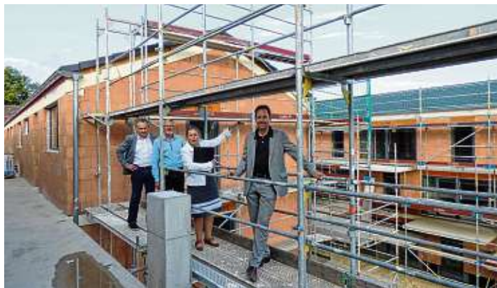
Aufsichtsrats Sachverständiger Luigi De Felice, die beiden Vorstände Joachim Blatter und Vera Federer sowie Bürgermeister und Aufsichtsratsvorsitzender Dr. Michael Klinger (von links) begutachteten die Baustelle zusammen mit dem Aufsichtsrat. Foto: Durlacher
