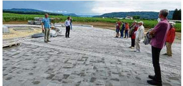
Insgesamt circa 50 Interessierte führten Bürgermeister Dr. Michael Klinger und Alexander Kopp vom Bauamt über die Baustelle.
