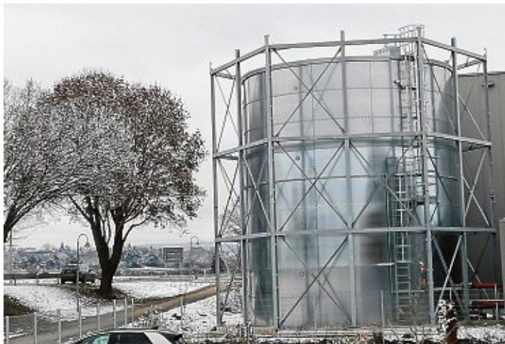
Der Sprinklertank wird mit Solarzellen verkleidet.
