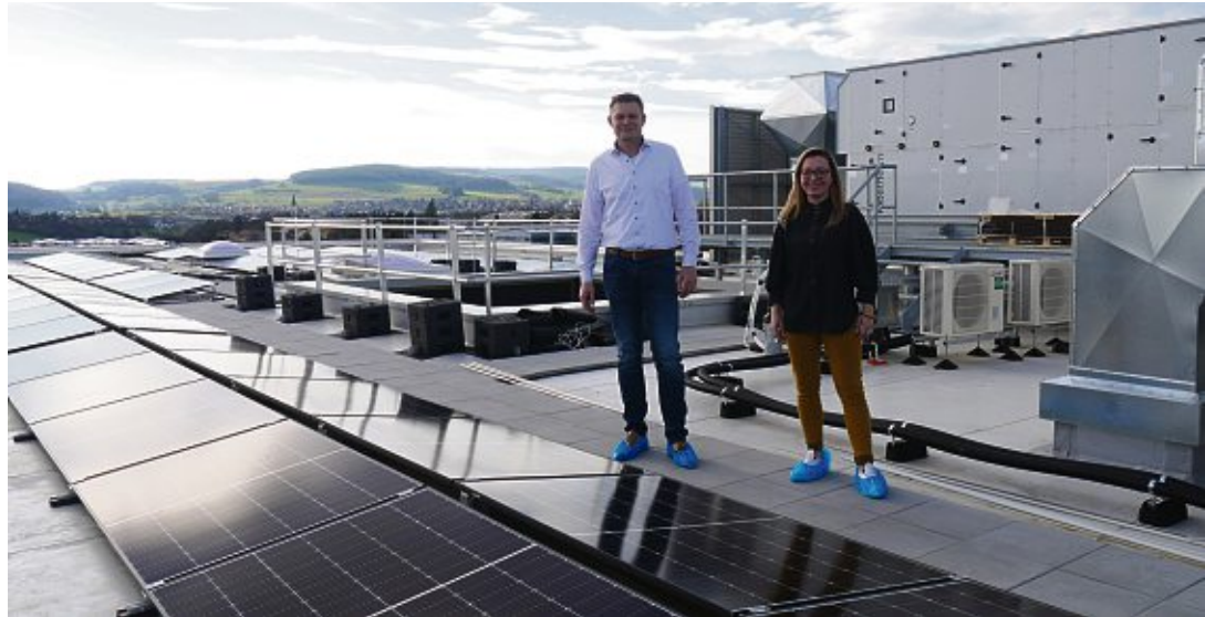
Jörg Parschat und Simone Böhler mit der leistungsstarken PV-Anlage.
